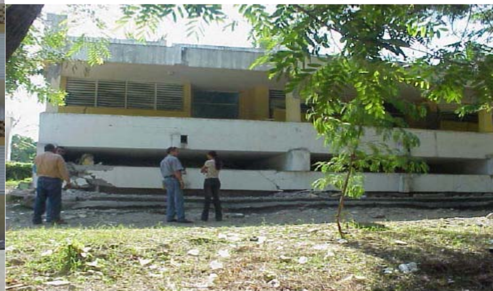
Figura 3: Escuela Reforma, piso colapsado.
