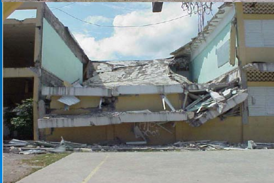
Figura 8: Liceo José Dubeau, parte colapsada.
